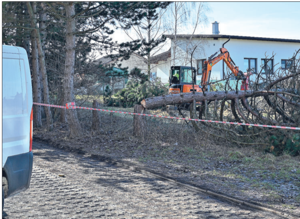
V minulém týdnu začaly první úpravy na pozemcích, kde mají vyrůst nové bytové a rodinné domy. Soukromý projekt v budoucnu ovlivní parkování na přilehlém sídlišti. FOTO: DAVID MACHÁČEK
