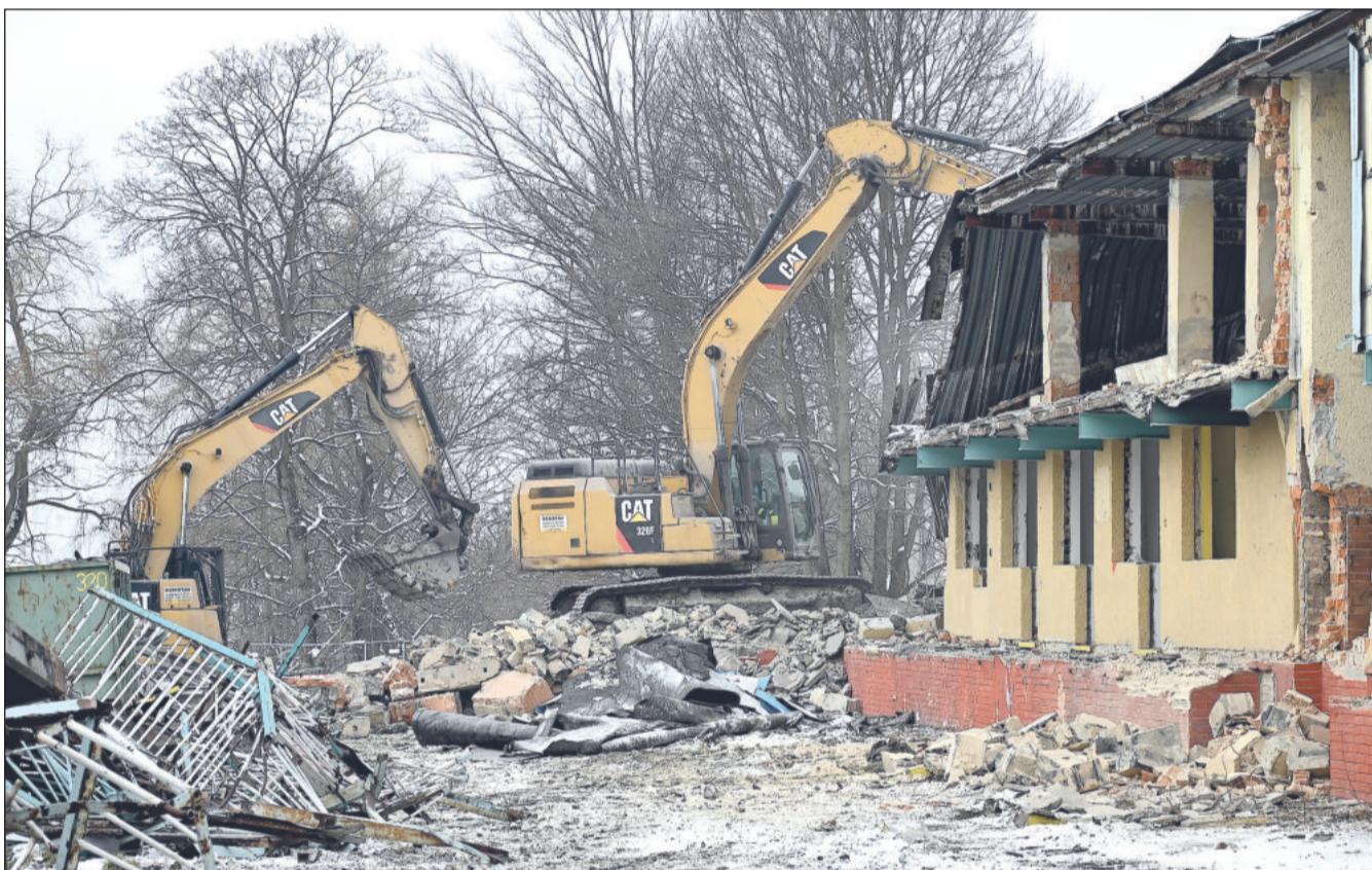
V úterý 3. února se těžké demoliční stroje zakously do provozní budovy koupaliště. Do konce týdne byl objekt zbourán a nyní bude firma pokračovat částečnou demolicí bazénových van. FOTO: DAVID MACHÁČEK
