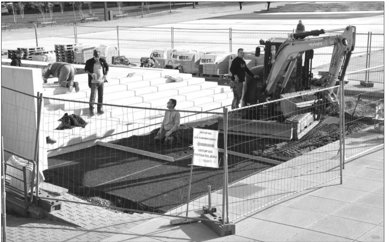
Realizační firma se v těchto dnech snaží dohnat mírný skluz v harmonogramu prací na stavbě hlavního přístupového schodiště do kulturního domu. První etapa by měla být ukončena 17. listopadu.
