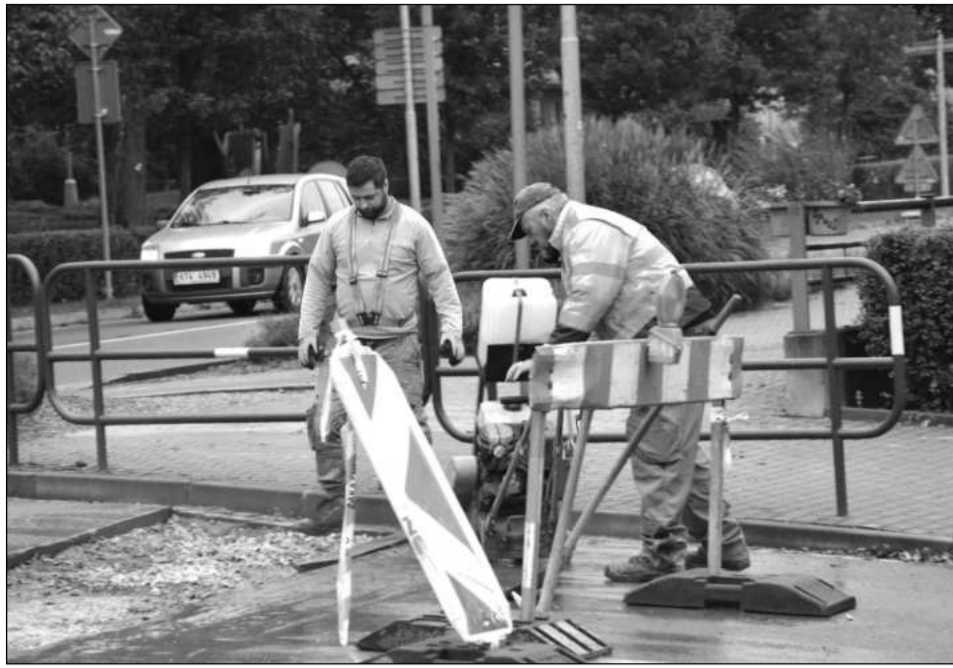
Potrubí v křižovatce ulic Kpt. Jaroše a Štefánikovy bylo vyměněno. V minulém týdnu pracovníci dokončili opravu komunikace a provoz na ní už je bez omezení. FOTO: DAVID MACHÁČEK
