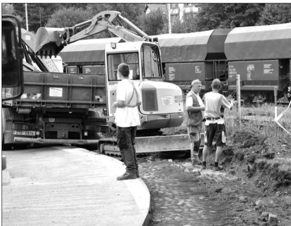
Nově budovaný chodník na ulici Štramberské má zvýšit bezpečnost chodců přecházejících na vlakové nádraží ve Štramberku. FOTO: DAVID MACHÁČEK
