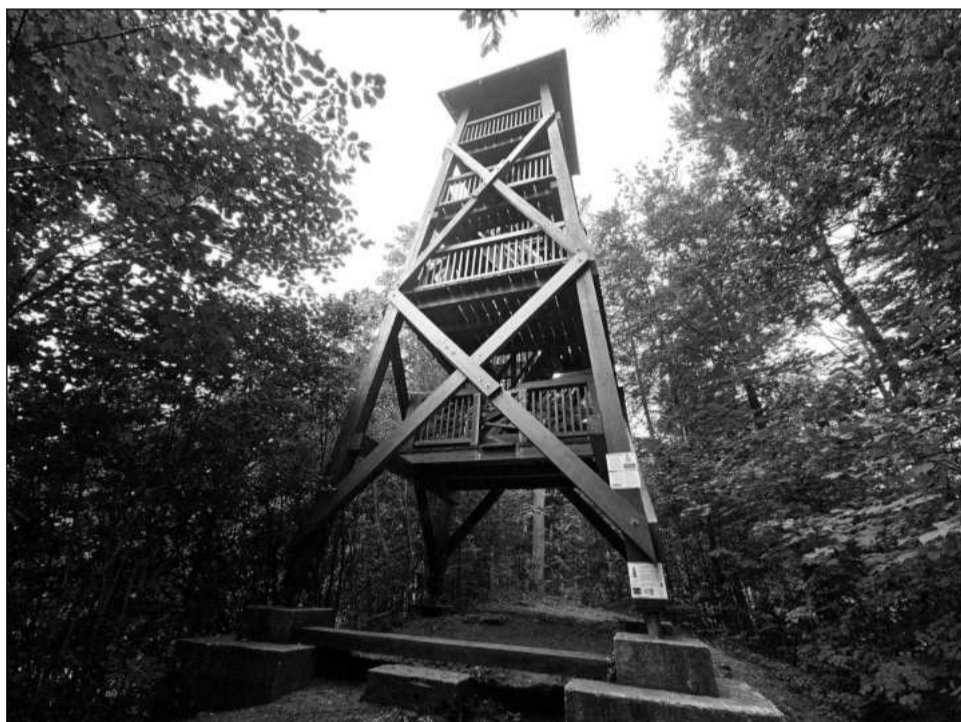
Na uzavřené Bezručově vyhlídce byl demontován spodní díl přístupového schodiště a stavba čeká na rozhodnutí o jejím dalším osudu.
