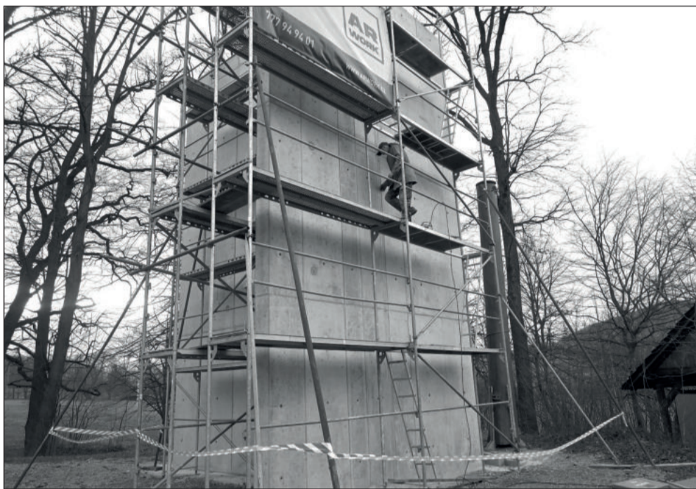
V areálu Vanaivan zatím stojí pouze betonový monolit, který tvoří základ budoucí lezecké věže. Skauti přesto věří, že už v létě bude sloužit svému účelu. FOTO: DAVID MACHÁČEK
