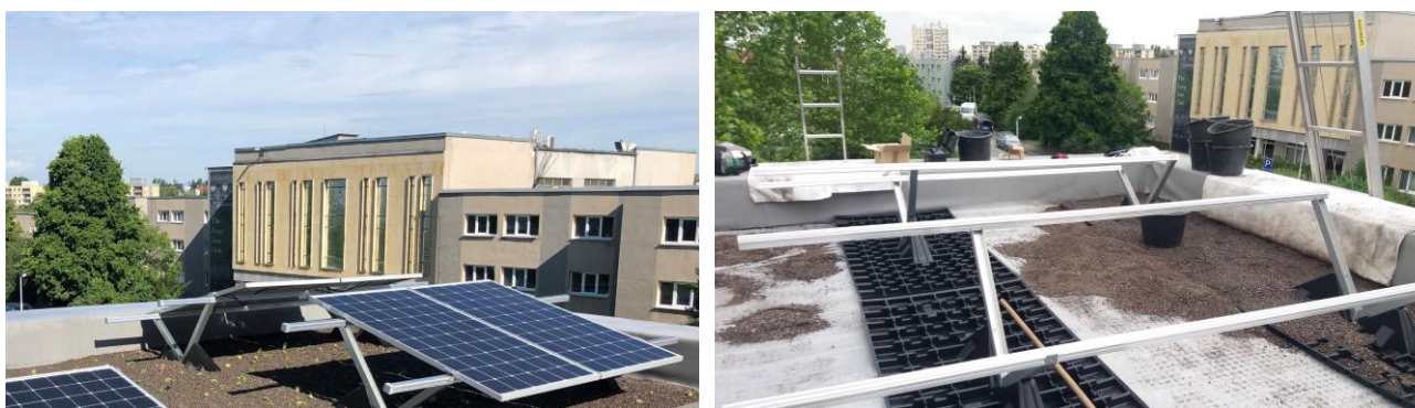
Obrázek 47: FVE lze kombinovat se zelenou střechou. Foto z realizace, zdroj: Jan Macháč (2021).
