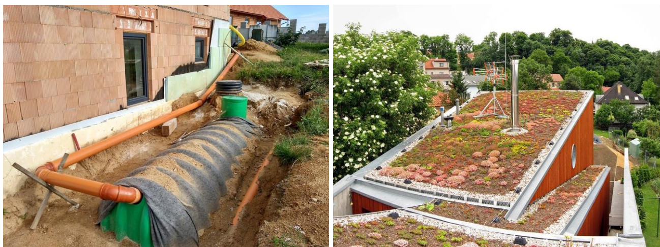
Obrázek 65: Příklady adaptačních opatření vstřícných k přírodě v sídlech, vlevo zachytávání srážkové vody pro její následné využití, vpravo extenzivní zelená střecha. zdroj: Metodika pro hospodaření s dešťovou vodou ve vazbě na zelenou infrastrukturu, ČVUT 2021.
