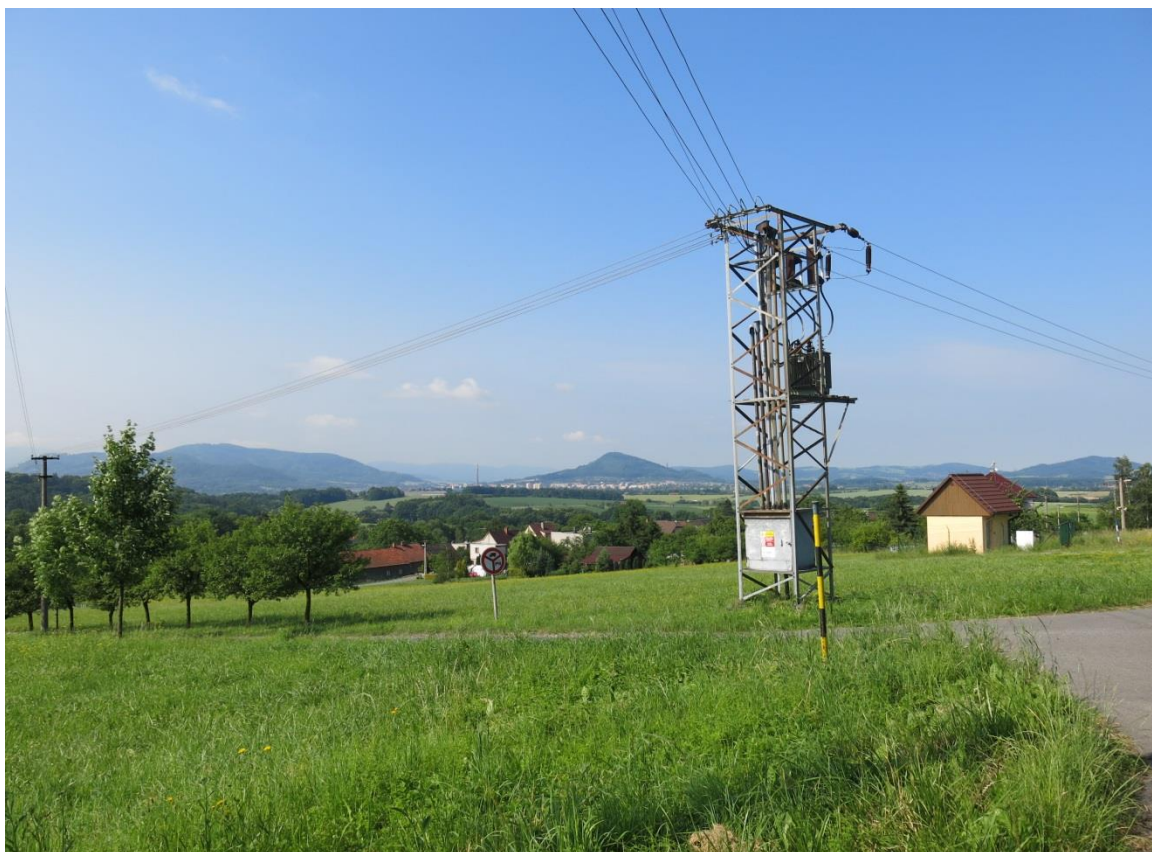
5) Pohledem směrem ke Kopřivnici od trafostanice.
