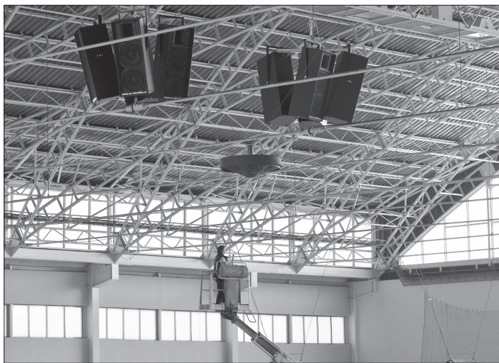
V minulém týdnu si instalace nového ozvučení vyžádala i omezení provozu na ledové ploše. Lepší kvalitu zvuku ocení návštěvníci hokejových utkání. FOTO: DAVID MACHÁČEK
