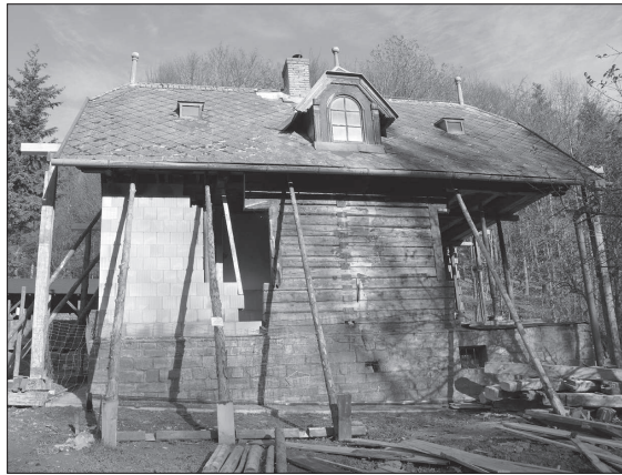
Původní roubenou část Hájenky na Janíkově sedle nahrazuje cihlová zeď. Po dokončení oprav by měl objekt vypadat zase jako dřív. FOTO: D. MACHÁČEK
