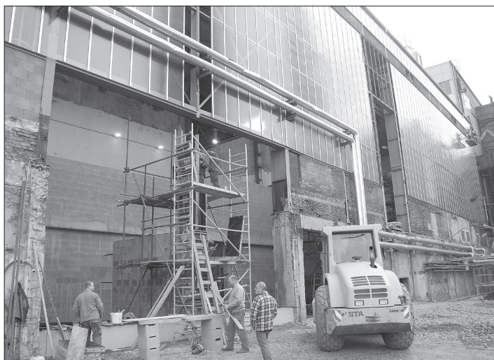
V rámci instalace nového kotle na spalování biomasy se oprav dočkalo také prosklení haly teplárny společnosti Komterm.
