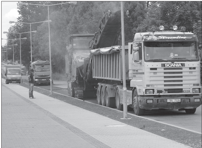
V sobotu dojde k uzavření provozu na ulicích Dělnické a Panské z důvodu pokládky nového asfaltového povrchu. Poškozená část byla odřezána v tomto týdnu. FOTO: DAVID MACHÁČEK
