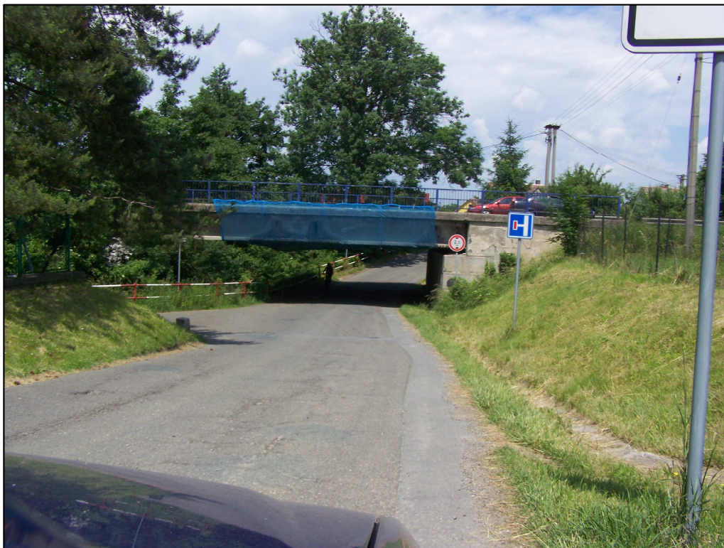
3. Pohled z ulice Dělnická na stávající podjezd pod mostní konstrukcí silnice II/480, patrný je špatný technický stav (zachycovací sítě).
