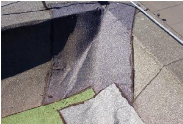
ZVLNĚNÍ A NÁSLEDNÉ TRHÁNÍ ASF. MODIF. PÁSŮ NA ATICE V ROHU, NEJVYŠŠÍ ZATÍŽENÍ VĚTREM - NEPŘÍPUSTNÉ
