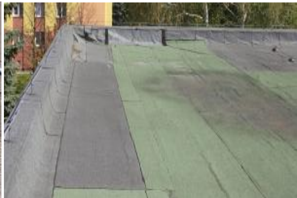
ZVLNĚNÍ ASF. MODIF. PÁSŮ V PLOŠE A NA ATICE – NEPŘÍPUSTNÉ
