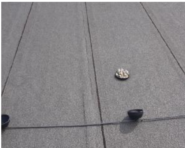
DALŠÍ PODÉLNÉ TRHLINY V PLOŠE STŘECHY -NEPŘÍPUSTNÉ
