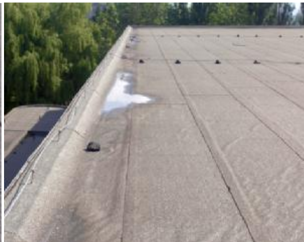
ZVÝŠENÁ ATIKA NA NEJNIŽŠÍ VÝŠCE PULTOVÉ STŘECHY A NEVHODNÉ VNITŘNÍ ODVODNĚNÍ URČENO K DEMONTÁŽI
